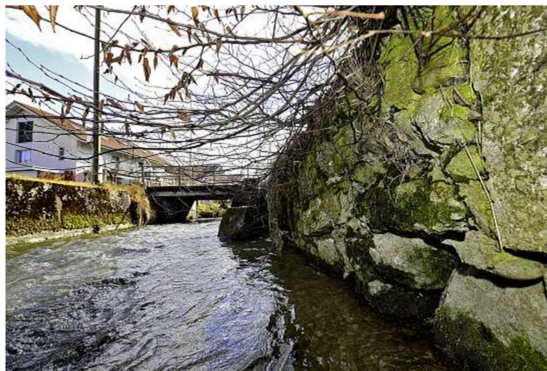
Marodes Mauerwerk: Beispielsweise sind die Mauern der Oesch entlang der Böschung bei der Spenglerei Daniel Baumberger in Koppigen rissig. Der Gemeinderat sieht im Dorf dringend Handlungsbedarf. Thomas Peter
