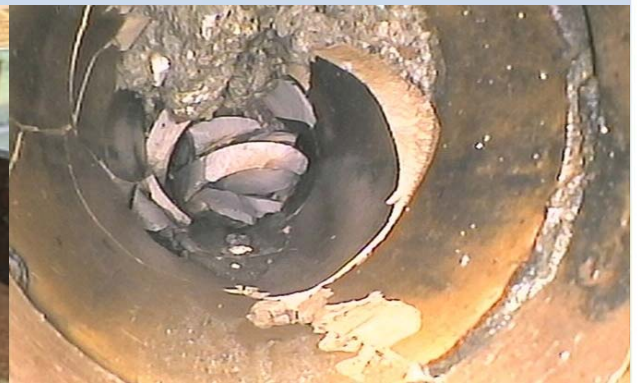
Beispiel Schadensbild Grundstücksanschlussleitung
