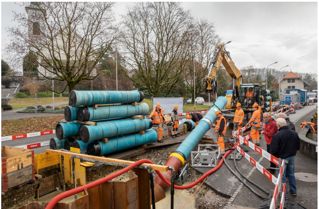
In Langenthal wurde über 125 Meter hinweg eine Wasserleitung DN 500 mit einem Radius von 60 Metern mit dem Horizontalspülverfahren eingezogen – ein Meilenstein in der Schweiz.
