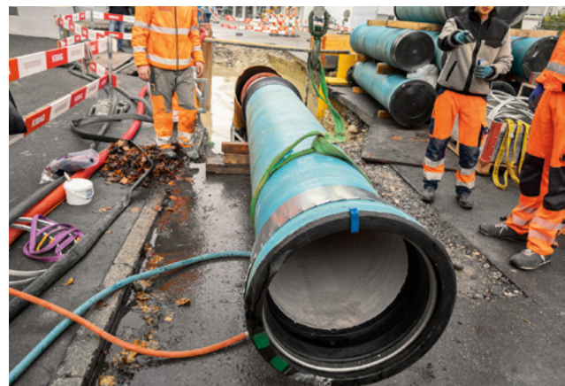
Trotz beengten Platzverhältnissen auf der Baustelle wurde die Rohrleitung an nur einem Nachmittag eingezogen.
