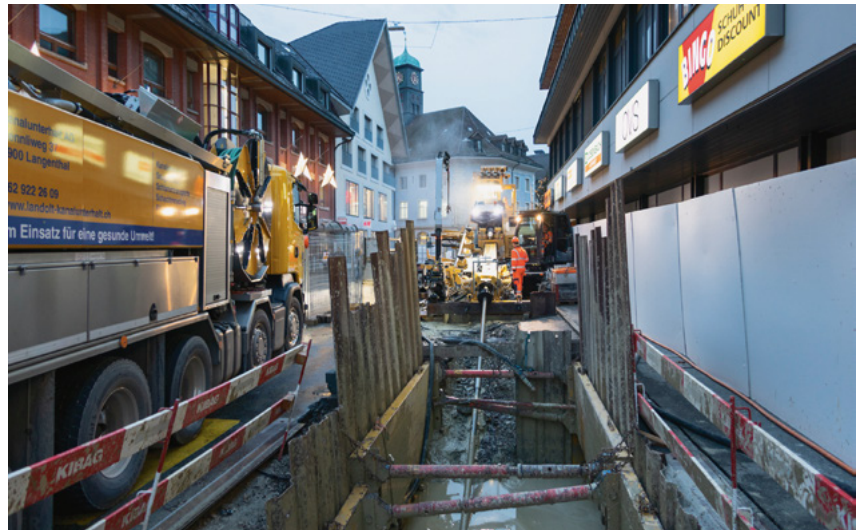
Verlegt wurden 36 Rohre mit 3,14 m Länge und zwei mit 6 m mit TIS-K Verbindung.
